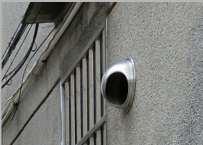
▲ 贴墙式排风口
