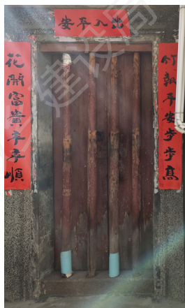
板门外的防盗设施
