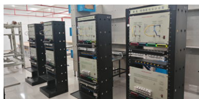
综合配线实训室
