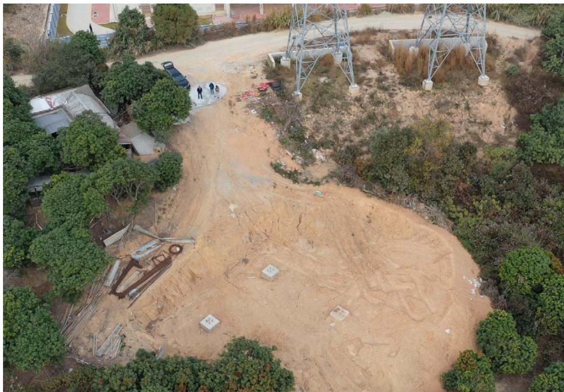
图 3.2-1 “新建揭阳至惠来铁路项目‘大南山直供牵引变电所’接入系统工程”塔基施工场地
