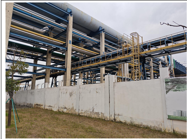
广东石化有限责任公司厂区与揭阳大南海石化工业区现有公共管廊交汇处
