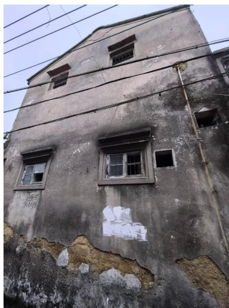
建筑质量较差
