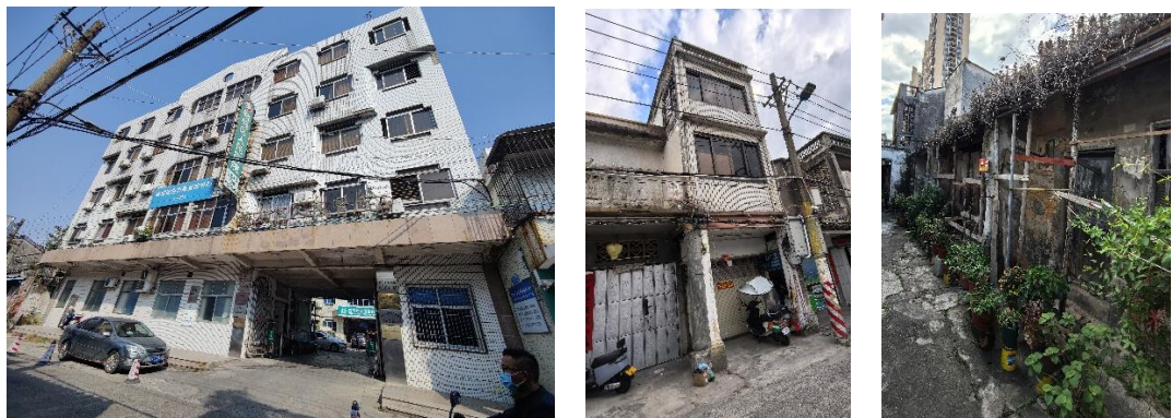
榕城区人民医院 立面不协调的建筑 坍塌破损的建筑
