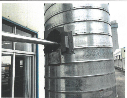
图 9.8 搅料车间废气处理前检测口 ◎Q7
