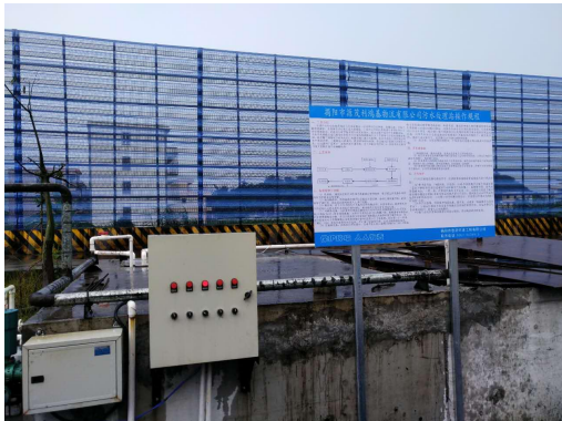
污水处理设施
