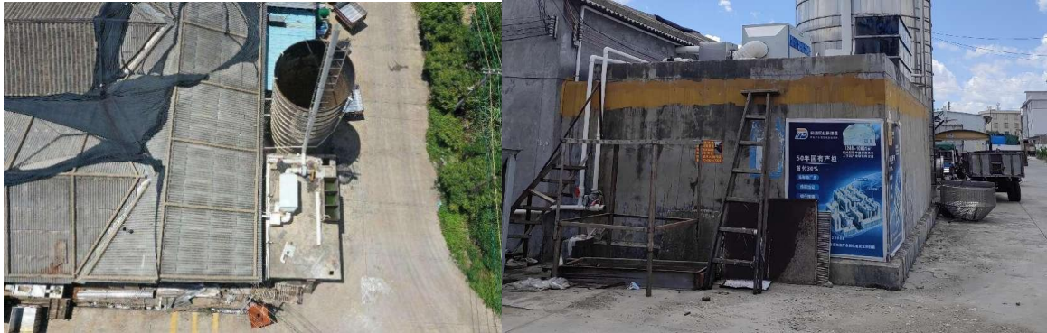
事故库房西侧室外景照片
