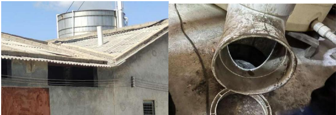
事故库房地下 3 号池排废气管照片
