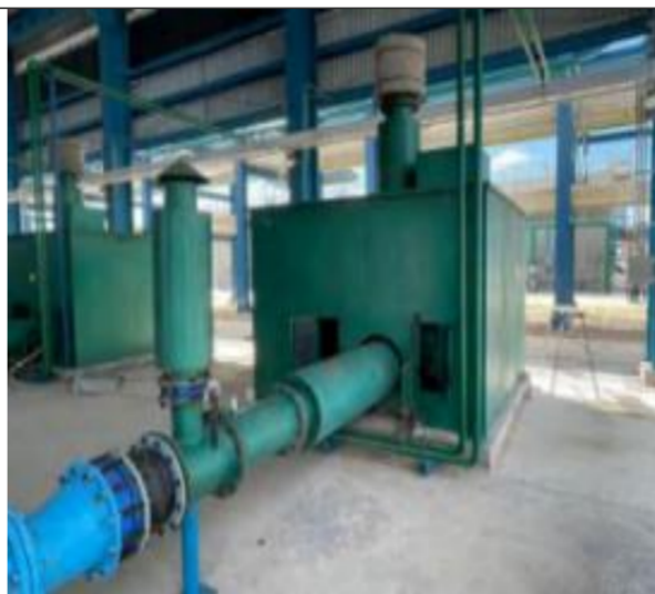
污水处理场风机隔音罩及消音器
