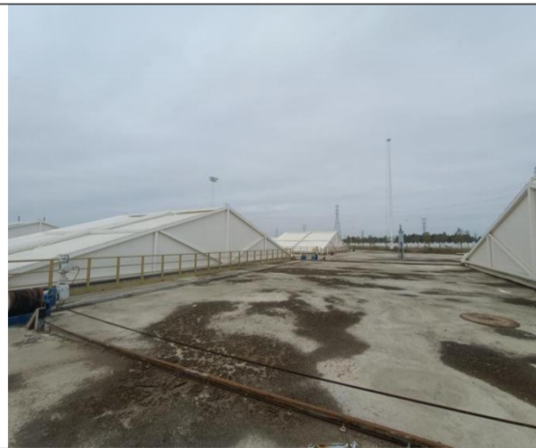
化工区事故应急池
