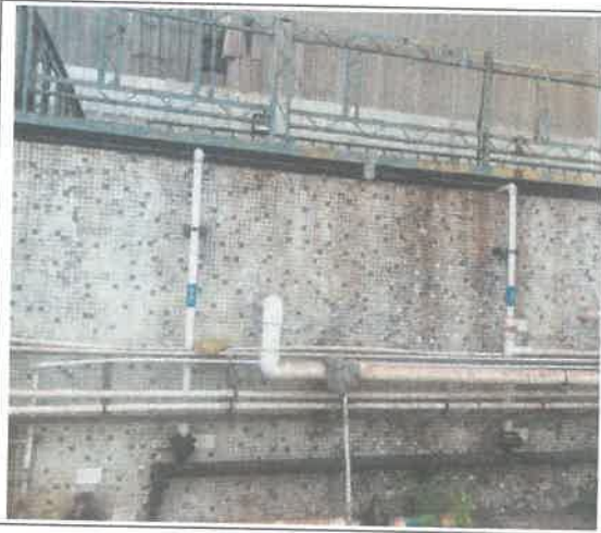
项目污水处理站
