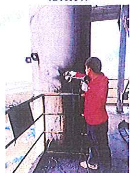
高炉煤粉制备废气处理后排放口 (DA007)
