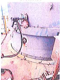
矿粉厂磨粉烟气处理后2#排放 口 (DA0016)
