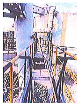
转炉一次烟气处理后排放口 (DA002)
