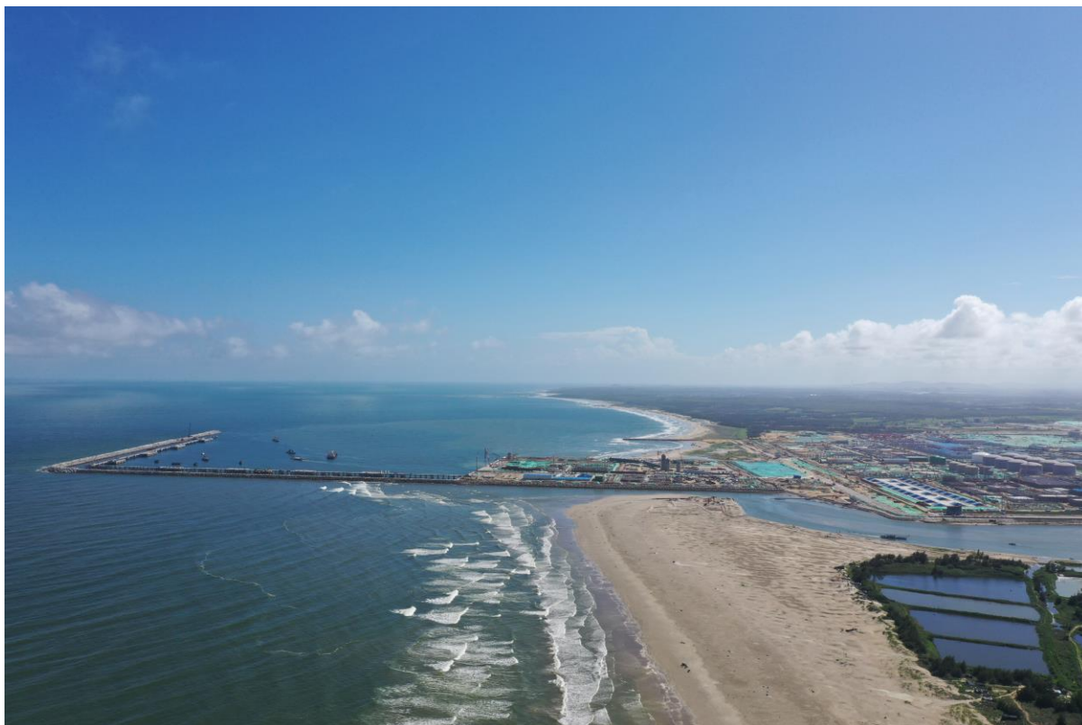
图 3.4.2-3 项目西侧中委广东石化 2000 万吨/年重油加工工程调整用海工程（在建）
