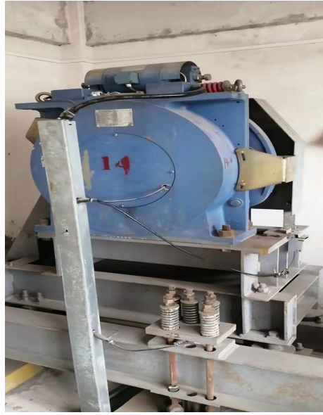
图 4.2.1 该小区电梯主机
